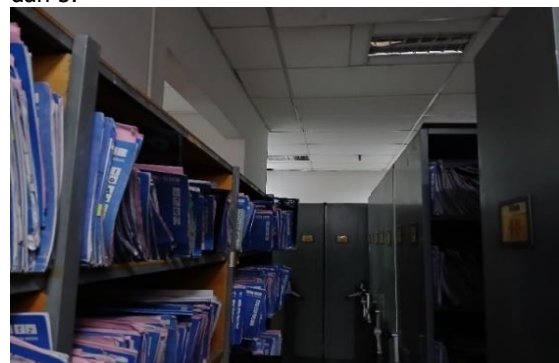
Gambar 4. Ruang Penyimpanan Berkas Dengan Lampu Tidak Berfungsi Sebagian
