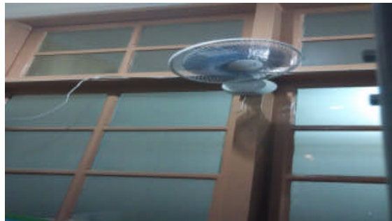
Gambar 11. ventilasi udara yang tertutup (Sumber oleh penulis,2015)
