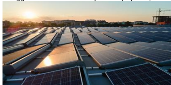
Gambar 1. Pembangkit Listrik Tenaga Surya
